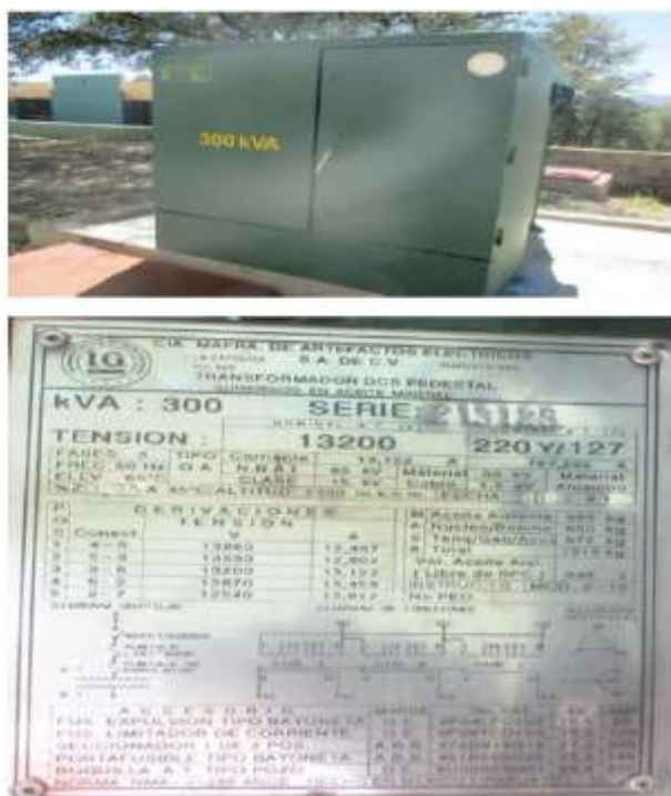
Figura 3 Transformador de Pedestal de 300 kVA
