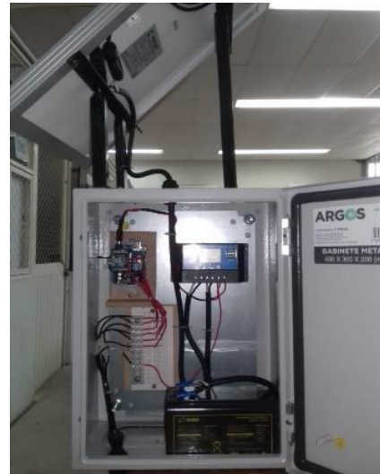
Figura 9 Vista frontal del gabinete terminado Fuente original
