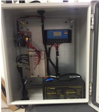
Figura 7 Gabinete con los dispositivos de transmisión Fuente original
