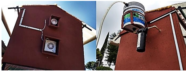
Figura 18 Sistema de extractores y dispensadores de agua Fuente: Elaboración propia
