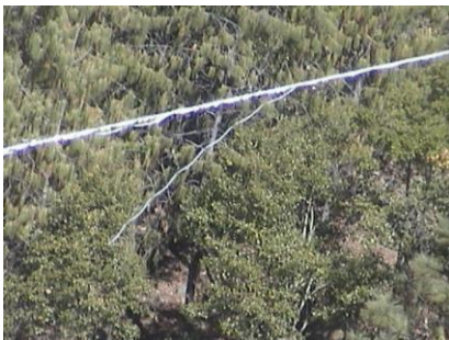
Figura 1 Efectos del desprendimiento de hilos del cable en las Líneas de alta tensión.
