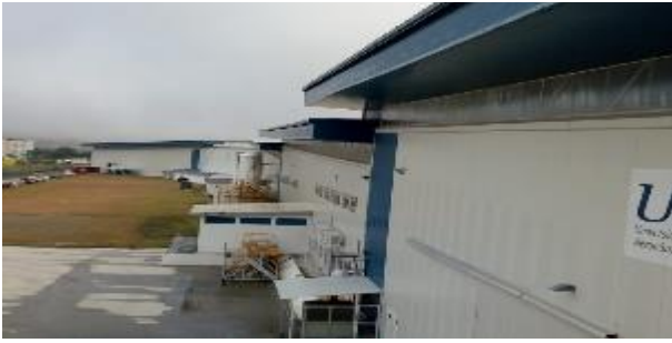
Figura 4 Área de la nave y caída de agua pluvial y condensada
