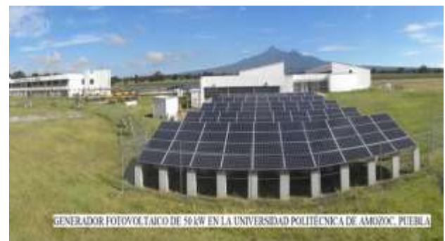
Figura 6 Parque solar UPAM
