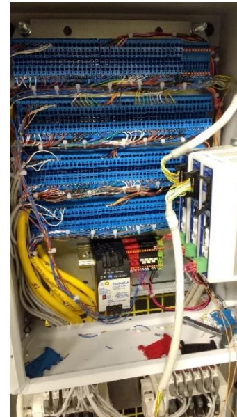
Figura 14 Caja I/Os Robots instalada Fuente: Elaboración propia
