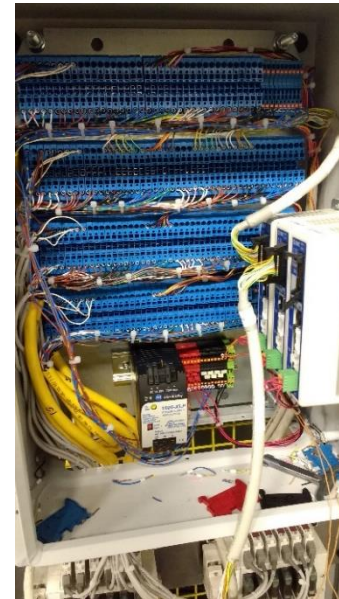
Figura 14 Caja I/Os Robots instalada Fuente: Elaboración propia
