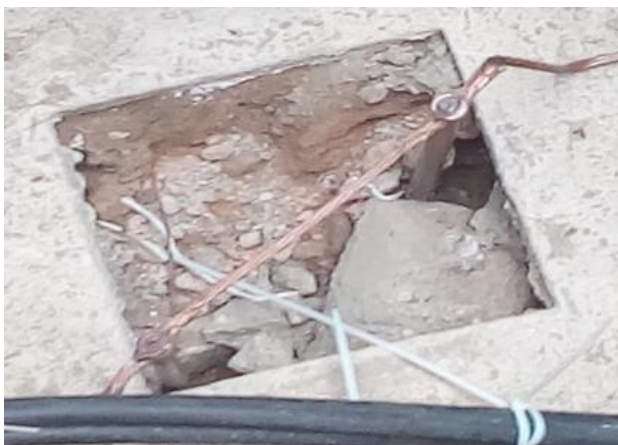
Figura 10 varillas del sistema de puesta a tierra Fuente: Elaboración Propia
