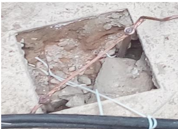
Figura 10 varillas del sistema de puesta a tierra Fuente: Elaboración Propia
