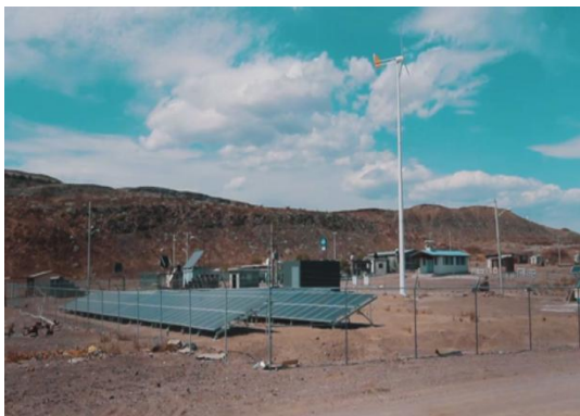
Figura 7 Planta de Autoabastecimiento de Puertecitos Baja California.
