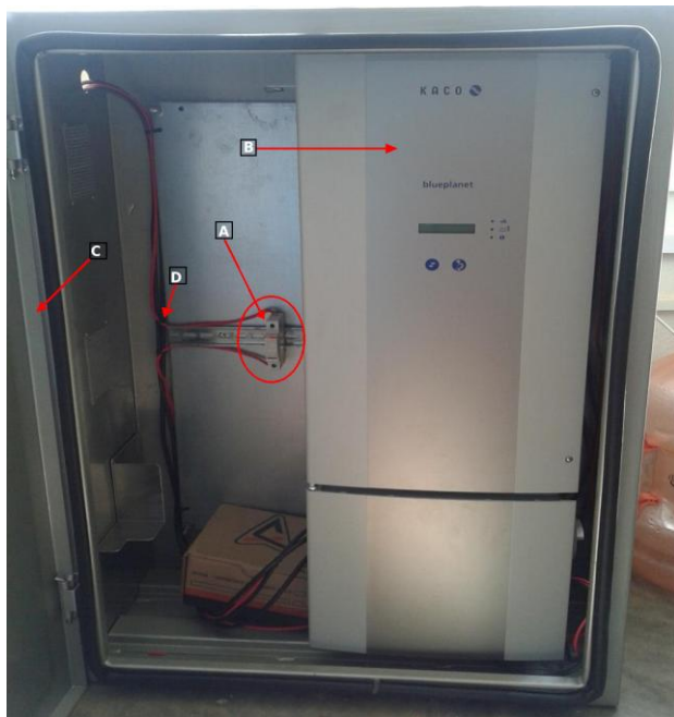
Figura 1 Inversor montado dentro del gabinete.
