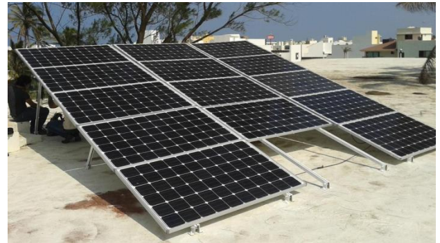
Figura 4 Vista física de los módulos sobre la estructura.
