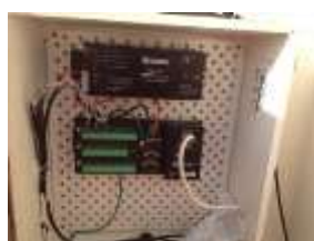
Figura 3 Caja para intemperie, batería, Datalogger CR1000 y convertidor para cable Ethernet
