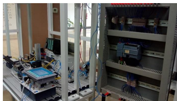
Figura 7 Comunicación Pantalla HMI y PLC S1200, pruebas de forzado de variables de salida
