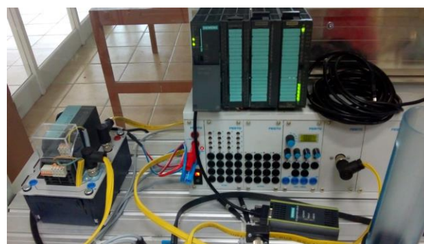
a) Implementación de un PLC S300 con comunicación MPI y tarjeta de Red ASI
