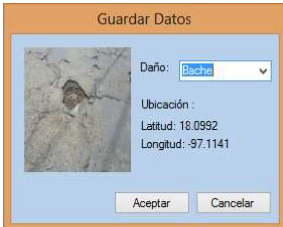
Figura 3 Ventana de descripción de daño identificado
