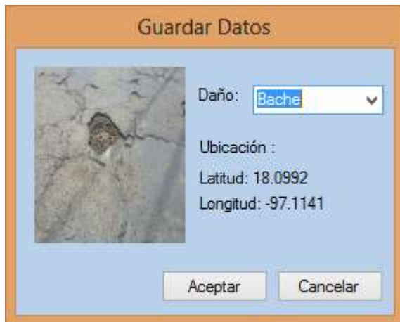
Figura 3 Ventana de descripción de daño identificado
