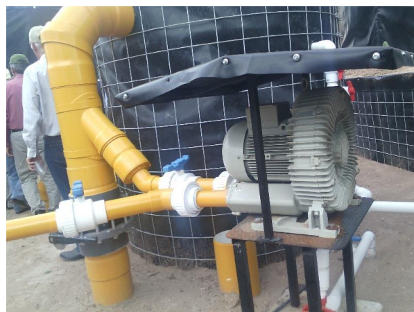
Figura 15 Sistema de purificación de Biogás y compresión constante
