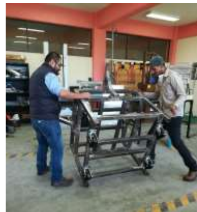
Figura 3 Proceso de construcción de la mesa giratoria ergonómica para prácticas. (Elaboración propia)
