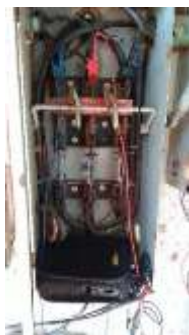
Figura 2 Analizador de redes instalado
