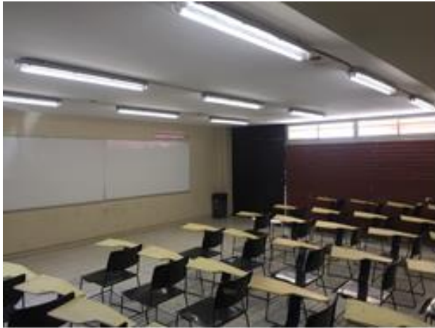
Figura 3 Aula A58 con sistema de iluminación LED Fuente: Elaboración Propia
