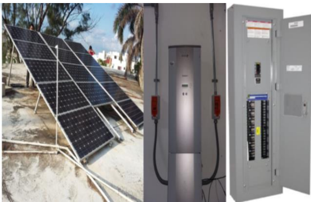
Figura 2 Sistema fotovoltaico en la facultad de ingeniería UV Campus Coatzacoalcos Fuente: Elaboración Propia
