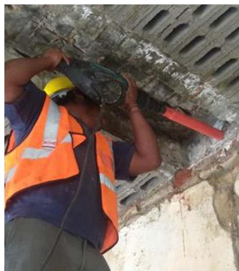
Figura 4 Extracción de núcleos de concreto con broca de diamante de 2". (Del Viso, J. R., et al., 2008)
