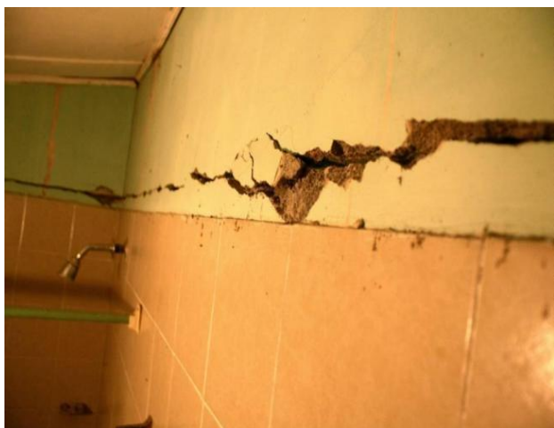
Figura 4 Agrietamiento en muros
