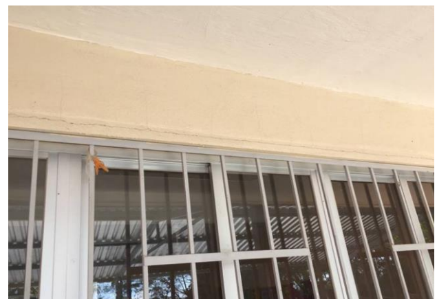
Figura 9 Fisura en trabe con un espesor de 4 mm
