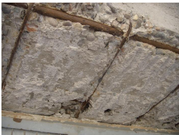
Figura 2 Corrosión de acero
