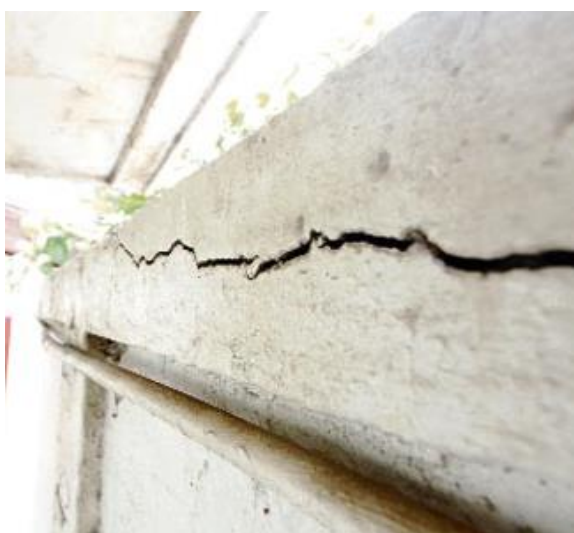
Figura 3 Agrietamiento en trabe
