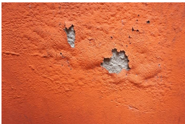
Figura 10 Pintura descascarada en muros
