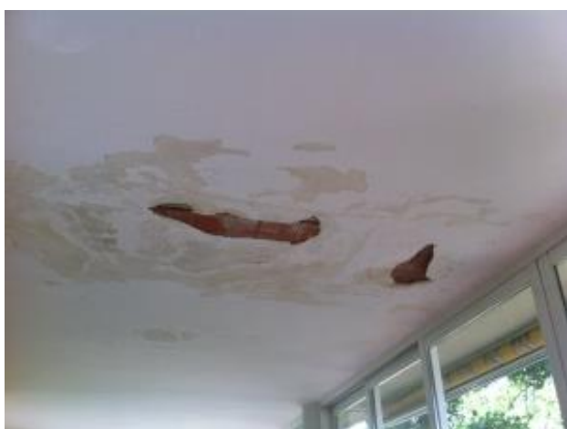
Figura 11 Humedad por filtración de agua en losa
