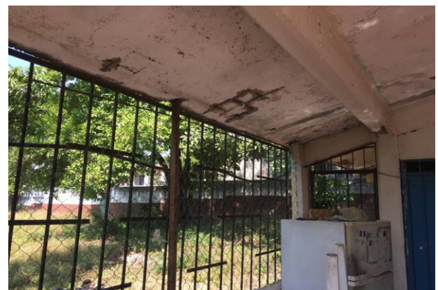
Figura 9 Corrosión de acero en losa
