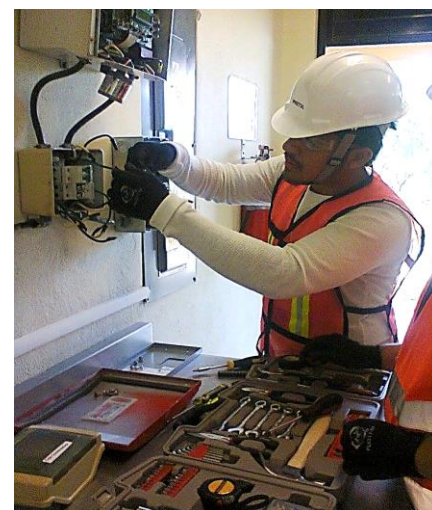
Figura 6 Conexión de componentes eléctricos Fuente: Elaboración Propia
