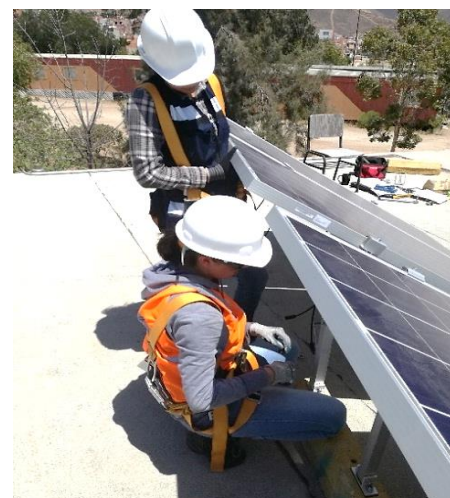
Figura 5 Fijación de módulos FV Fuente: Elaboración Propia
