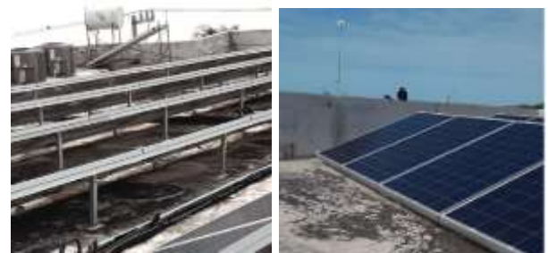
Figura 5 Vista parcial de la planta de Generación Distribuida Fotovoltaica (GD-PV) en Campeche. Se aprecia una barda perimetral y la nula separación de los módulos al techo, evitando el buen enfriamiento de los módulos Fuente: Elaboración Propia
