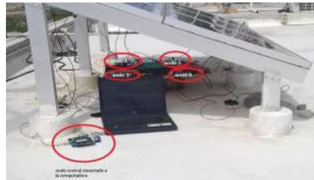
Figura 5 Implementación de la red CAN en cuatro módulos de 50W en la Facultad de Ingeniería de la Universidad Autónoma de Yucatán Fuente: Elaboración Propia
