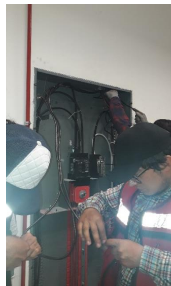
Figura 7 Conexión a centro de carga Fuente: Elaboración propia
