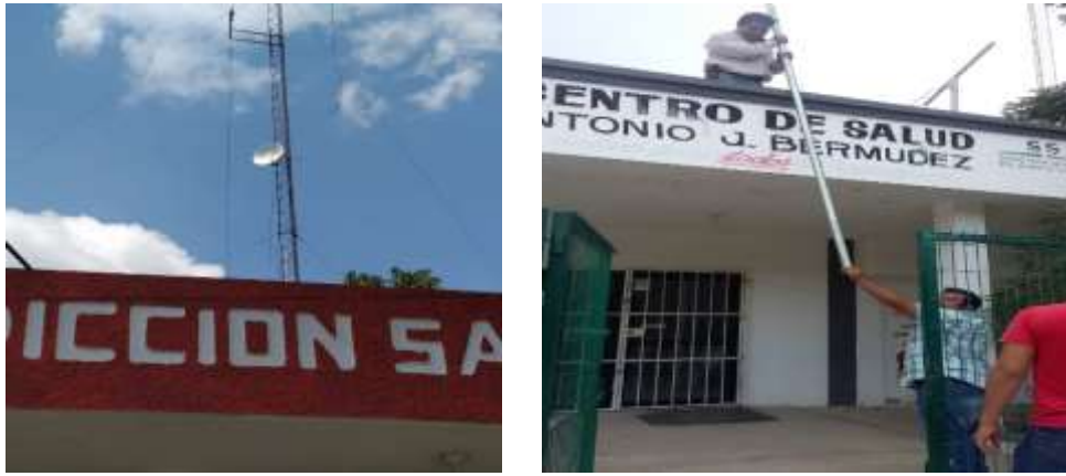
Figura 8.2 Profesores del ITSP instalando antenas de comunicación
