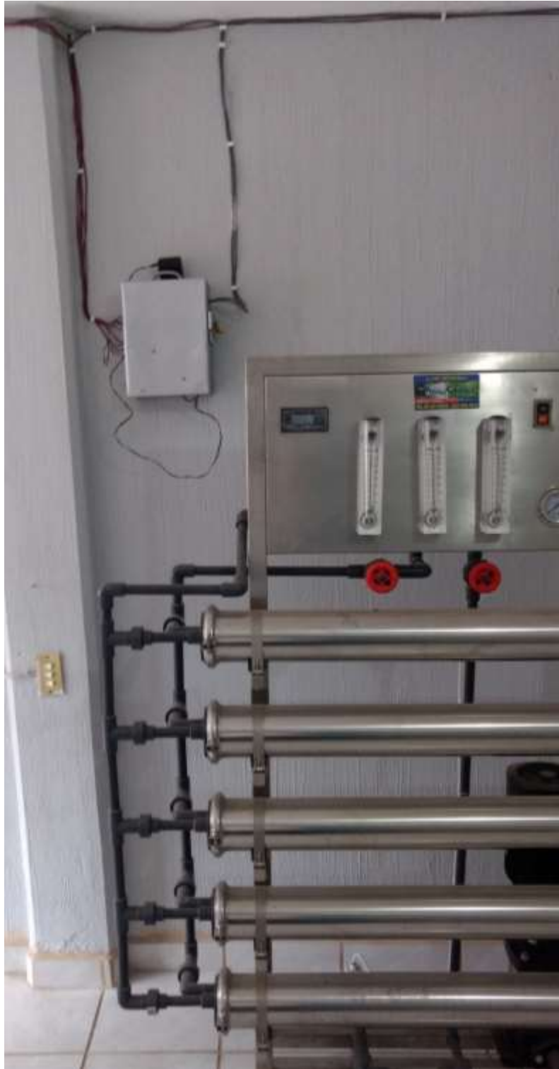
Figura 2723 Sistema de seguridad instalado
