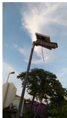
Figura 8.8 Panel solar fotovoltaico
