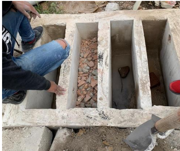
Figura 3 Filtros de grava, gravilla, arena, escombro, tezontle y carbón activado
