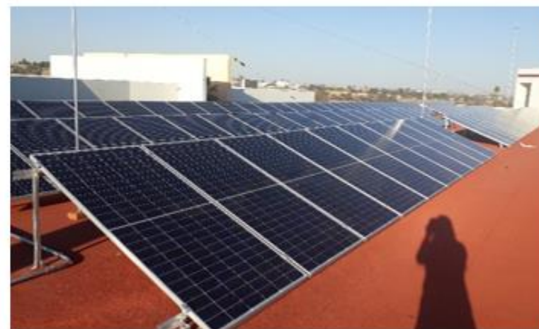
Ilustración 8. Instalación terminada. "Elaboración propia"
