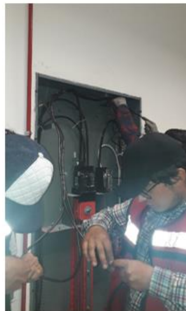
Ilustración 7. Conexión a centro de carga. "Elaboración propia"
