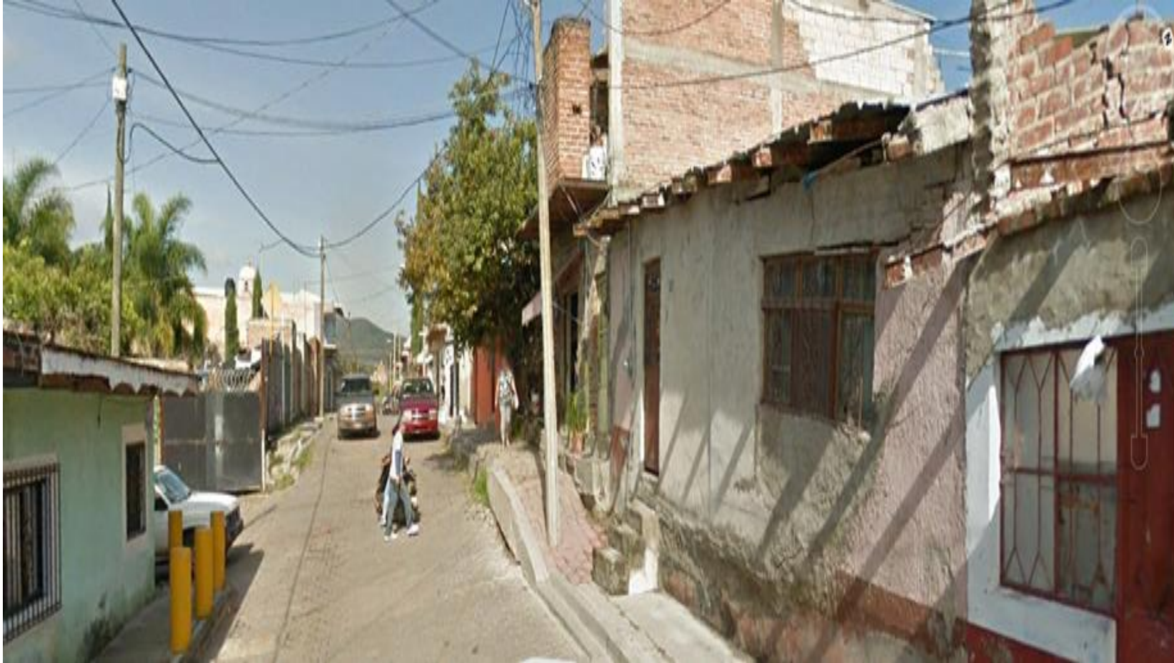
Figura 7. Vialidad y casas dañadas por efecto de un asentamiento en Jocotepec (Fotografía del archivo de Maciel-Flores).
