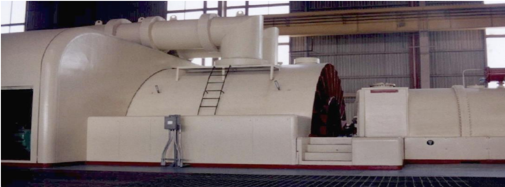
UNIDAD 4 CENTRAL TERMOELÉCTRICA VALLE DE MÉXICO TURBINA DE VAPOR 300 MW.
