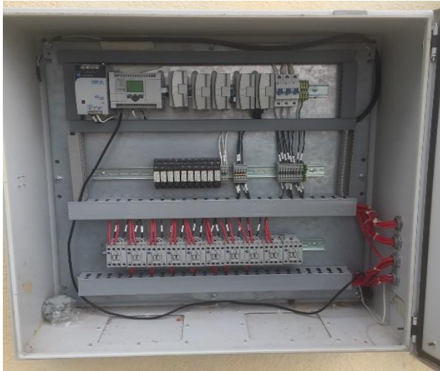
Figura 6 PLC instalado en edificio A5
