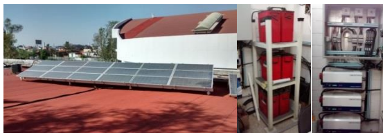
Figura 1 Sistema fotovoltaico autónomo.
