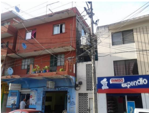
Figura 1 Cableado eléctrico en México.
