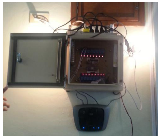
Figura 8 Unidad de Control de Acceso Automático
