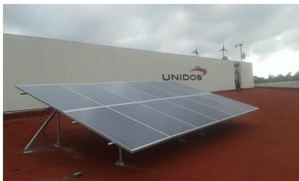
Figura 1 Sistema fotovoltaico de 3kWp en las instalaciones de la UTBB, primera etapa
