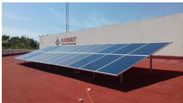
Figura 2 Sistema fotovoltaico de 6 kWp en las instalaciones de la UTBB, segunda etapa
