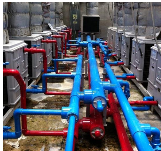
Figura 2 Distribución de las bombas de calor Fuente: Elaboración Propia
