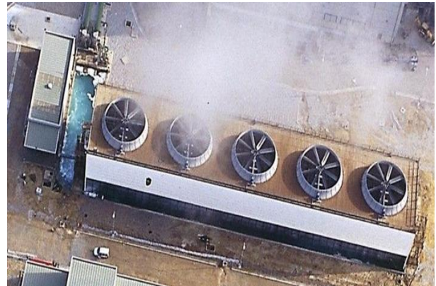
Figura 6 Torres de enfriamiento sistema convencional
